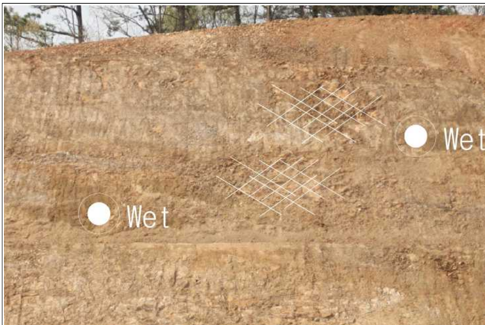
【그림 13】 A 영역 상세사진 (세편화된 암석 및 지하수 유출)
